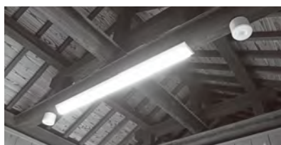
（人感センサーとLED照明取付）
