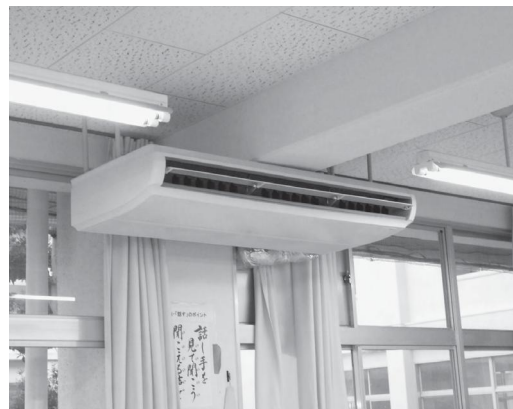
公立学校に設置されたエアコン
