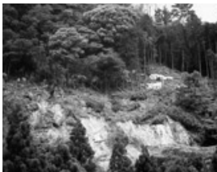
▲人工林の伐採跡地では、山の斜面がすべっている(国見町)
