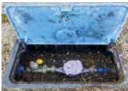
水道メーターボックス
