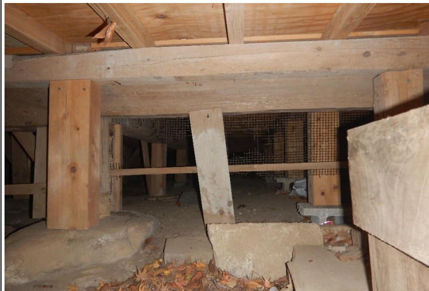
破損2 北縁床下(南を見る) かつての床不陸調整・補強
