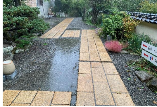
客殿前通路部分の滞水
