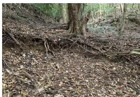
法面の浸食によるズレ
