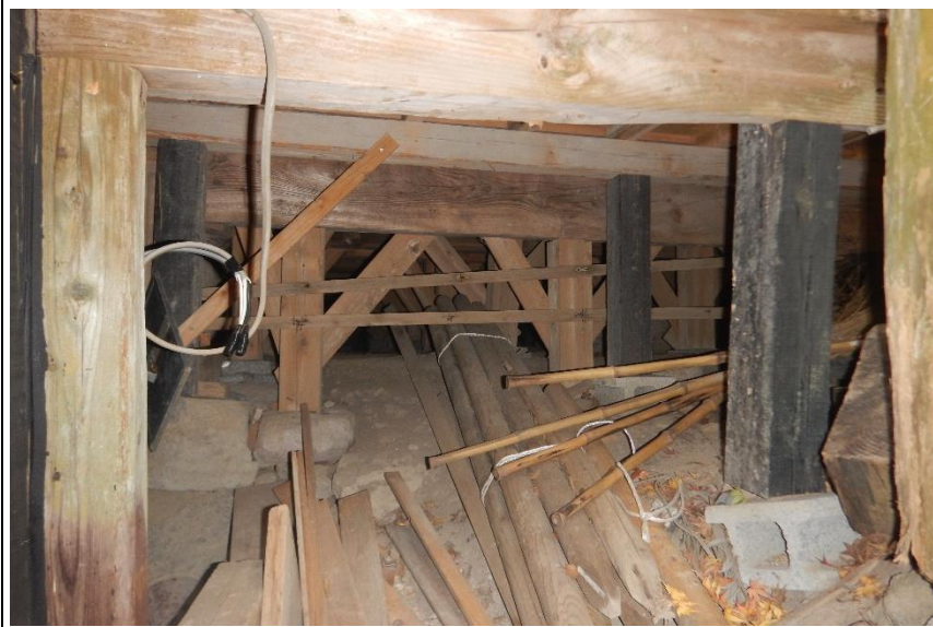
破損3 同上東より かつての床不陸調整・補強と柱傾斜調整・補強
