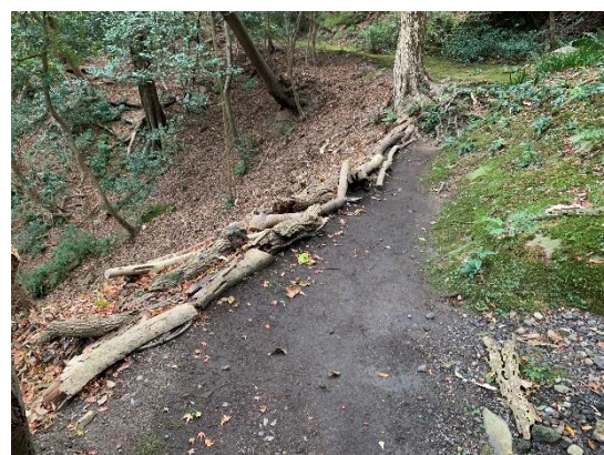
西古参道の法肩の崩れ
