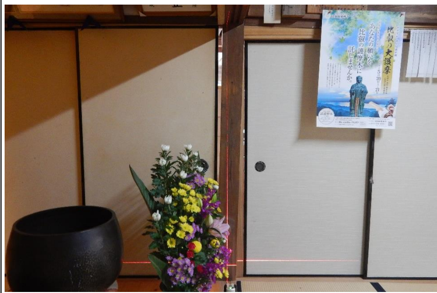
破損1 北列北面中央柱
