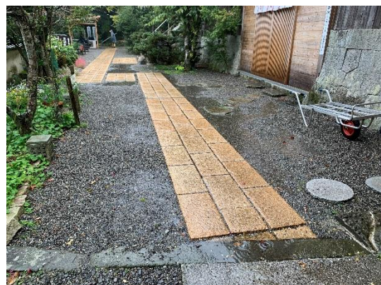
降雨時の滞水
