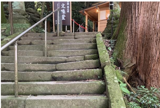
石段の根による浮き上がり
