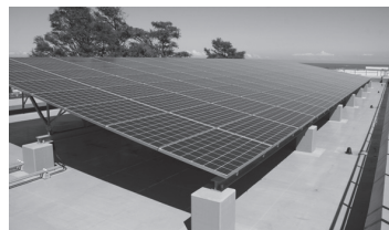
国東中学校には出力30kWの発電設備を設置しました
