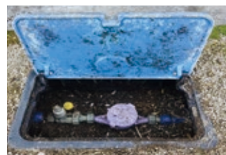
▲水道メーターボックス
