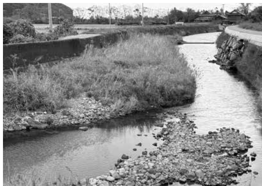
堆積土石で河道断面積が小さくなり、越水して決壊寸前になった箇所
