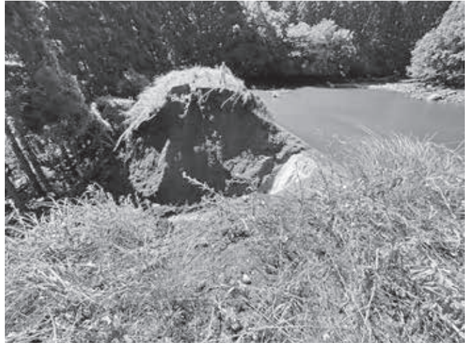
決壊した益ヶ原池 (安岐町明治)
