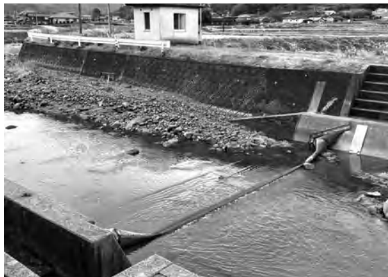
堆積土砂で倒伏感知管が詰まり、自動倒伏しなくなった頭首工
