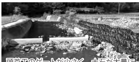
頭首工のゲートが小さく、土石が大量に堆積し、河道断面積が少なく決壊した現場
