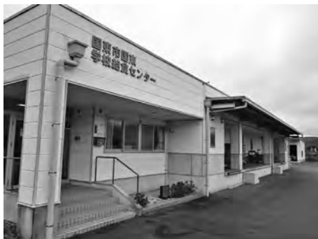
老朽化が進む給食センター
