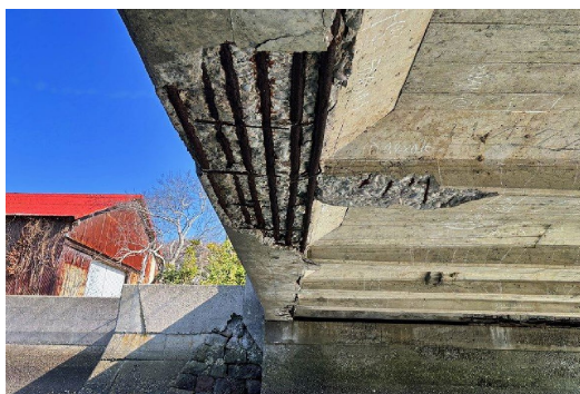
【主桁下面の剥離・鉄筋露出】
