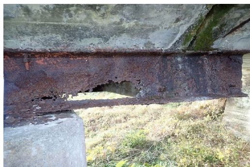
【主桁の腐食による断面欠損】
