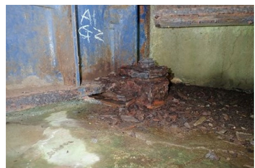
【支承部の腐食】
