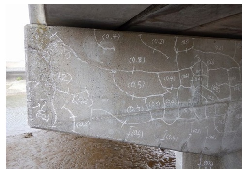
【橋脚の亀甲状ひびわれ】
