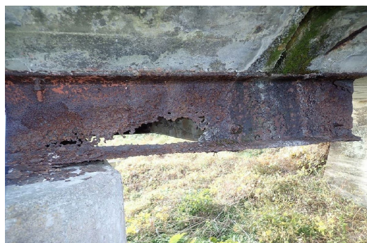
【主桁の腐食による断面欠損】
