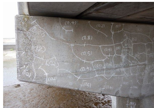
【橋脚の亀甲状ひびわれ】
