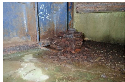
【支承部の腐食】
