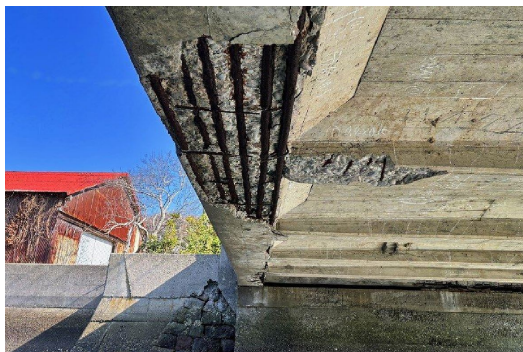
【主桁下面の剥離・鉄筋露出】
