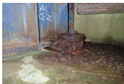
【支承部の腐食】
