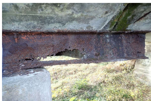
【主桁の腐食による断面欠損】
