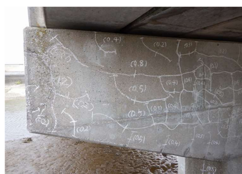
【橋脚の亀甲状ひびわれ】
