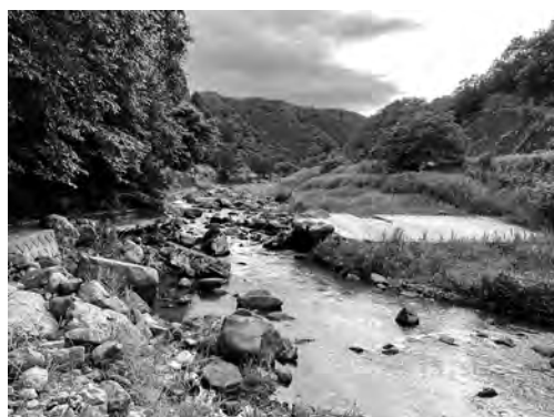
頭首工の崩壊現場
