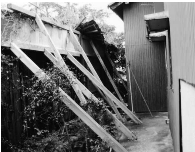
倒れかかる危険空き家に自己防衛
